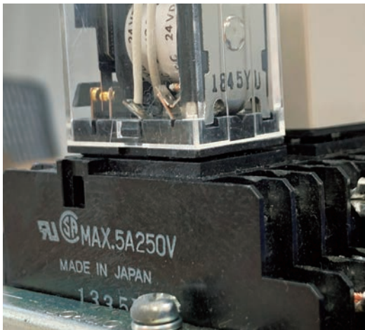
差し込み状態が良い例
