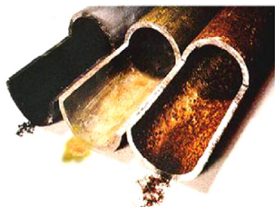
図-1 配管内の汚染
